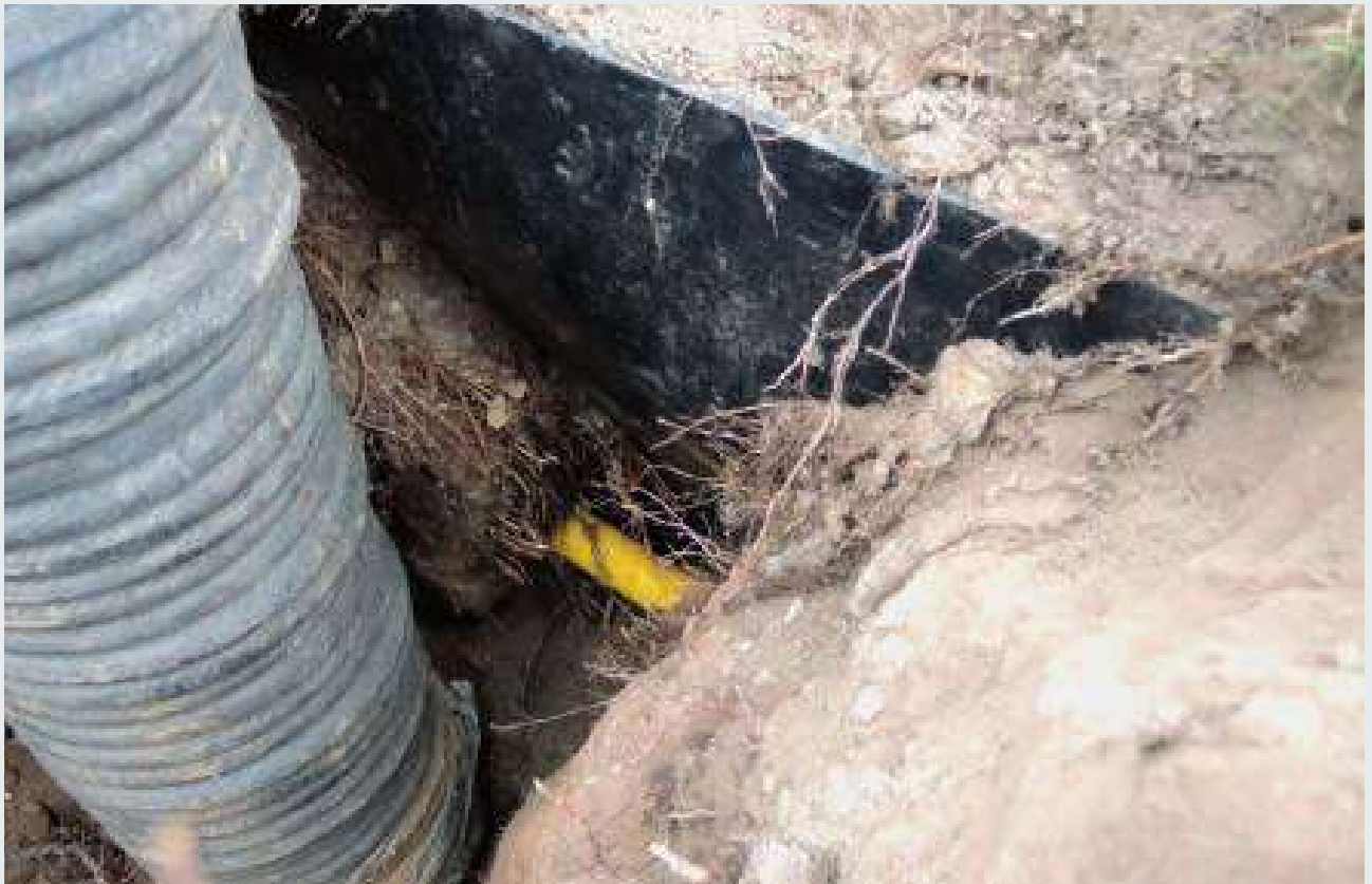
Bild 5: Wurzelwachstum im Verfüllmaterial des Leitungsgrabens während der Aufgrabung unter Einsatz eines Saugbaggers an einer Gasversorgungsleitung (gelb) mit Wurzelschutzplatte (schwarz) (Quelle: C. Heidger)
